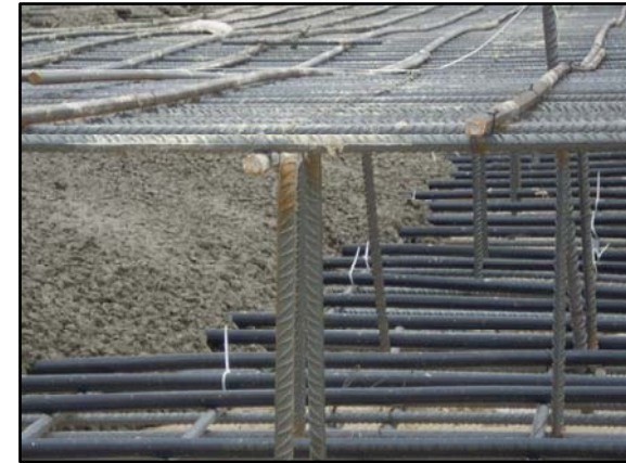
Detalle de las sondas geotérmicas en el momento del vertido de hormigón
